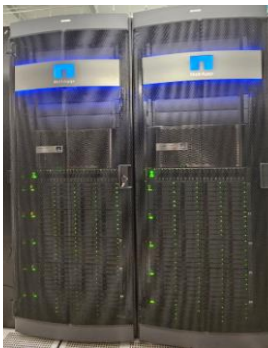
Figura 1: Rack 77 (esquerda) e 78 (direita) Portas Fechadas
