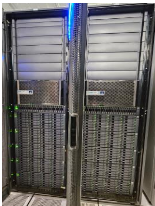
Figura 2: Rack 77 (esquerda) e 78 (direita) Portas Abertas
