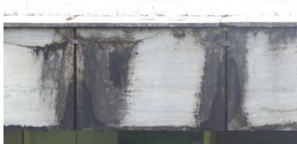
Figura 15 - Edifício Principal - Exemplo de peças manchadas
