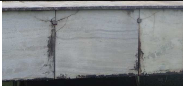
Figura 13 - Edifício Principal - Exemplo de placas partidas junto à fixação superior
