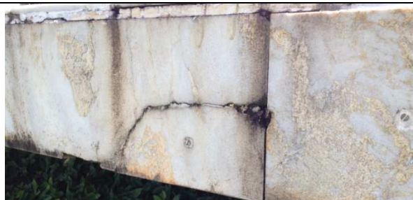
Figura 24 - Rampa do Edifício Principal - Exemplo de danos
