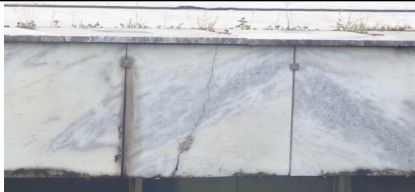
Figura 14 - Edifício Principal - Exemplo de placas partidas em outros pontos
