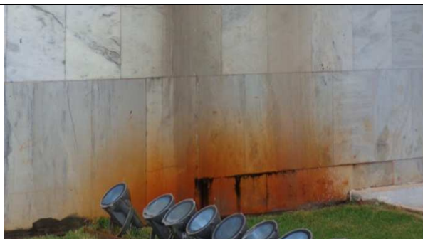
Figura 9 - Túnel do Edifício Principal - Peças manchadas
