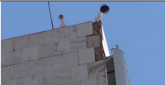
Figura 5 - Anexo 01 - Exemplo de dano: placas faltantes
