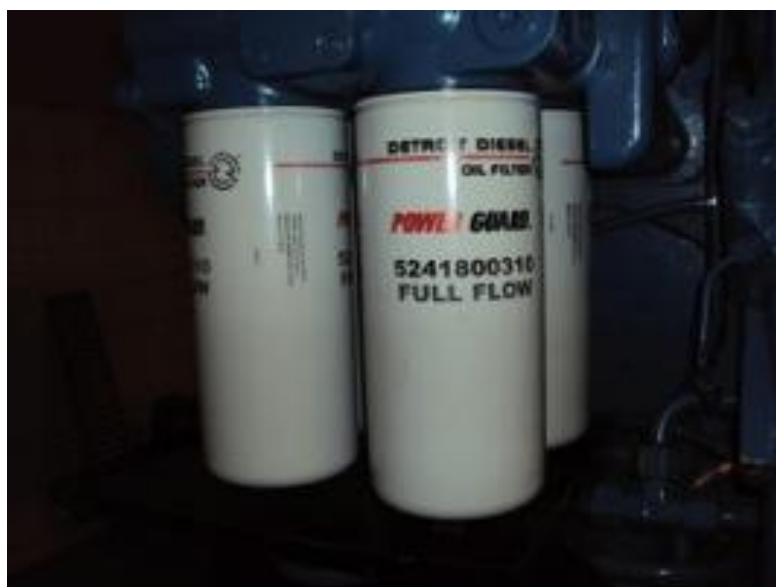
Foto 8: Detalhe dos filtros de óleo de um motor (4 filtros por motor).
