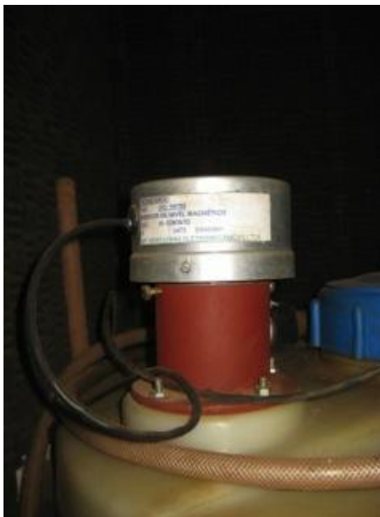
Foto 86: Detalhe do sensor magnético de nível mínimo de combustível.
