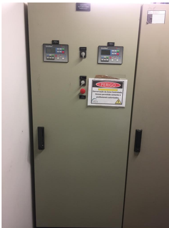
Foto 70: Vista do quadro de comando, sincronismo automático e potência dos grupos motores-geradores.
