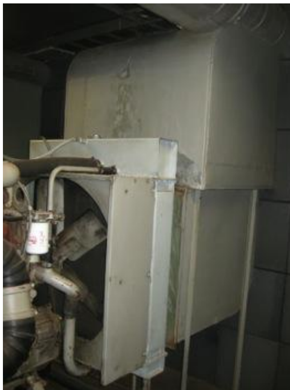
Foto 53: Outra vista do radiador e do sistema de exaustão do motor.
