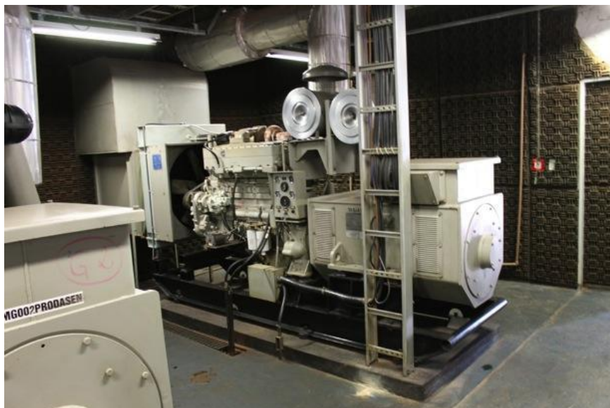
Foto 45: Visão geral do grupo motor-gerador 1. Nota-se o radiador e saída de ar, o motor, instrumentos, gerador, leito de condutores, sistema de admissão e escape de ar, entre outros. Na parte esquerda, o grupo motor-gerador 2.
