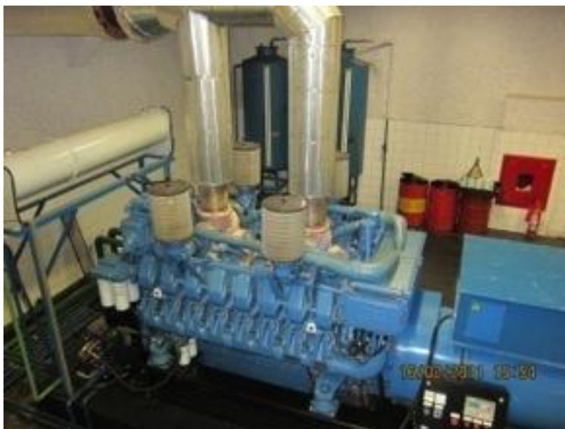
Foto 4: Vista aérea do motor, gerador, totem de automação, reservatório de fluido de refrigeração (branco, horizontal) e dutos do sistema de exaustão de gases. Foto tirada do Grupo Motor-Gerador 1; o Grupo Motor-Gerador 2 é idêntico ao Grupo Motor-Gerador 1.
