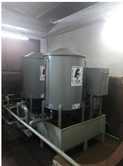
Foto 30: Interior da guarita mostrando filtro prensa, tanques de diesel filtrado e bomba de transferência de combustível.
