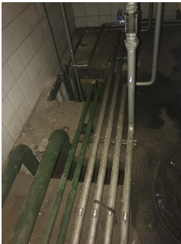
Foto 27: Detalhe das linhas de combustível (alimentação e retorno para cada um dos grupos geradores, em cinza).
