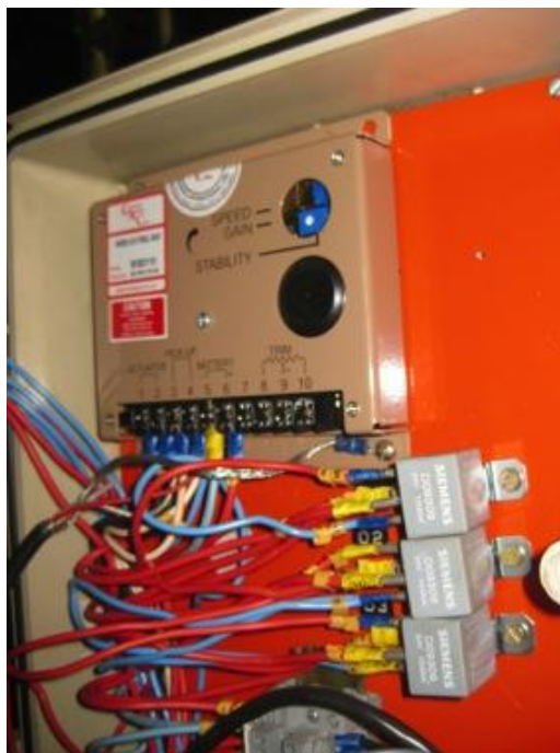
Foto 88: Detalhe do controlador automático de velocidade e dos relés auxiliares do sistema.
