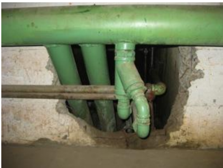
Foto 34: Detalhe das interferências atualmente existentes entre a tubulação de água de refrigeração e a tubulação de combustível.
