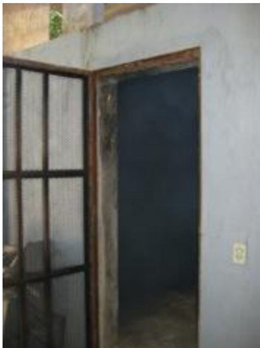
Foto 40: Acesso ao misturador de ar logo na base da chaminé.
