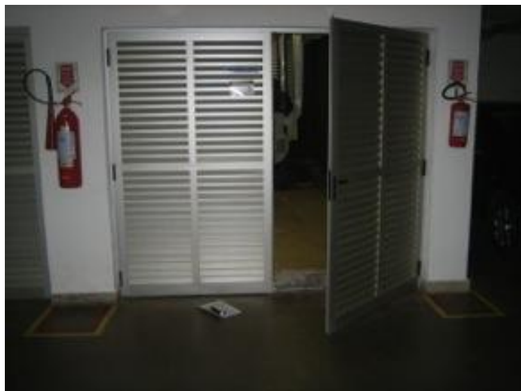
Foto 72: Entrada da sala do grupo motor-gerador do Sistema de Geração de Energia Elétrica de Emergência do Interlegis. A chave de transferência está localizada na sala de quadros, cuja entrada pode ser vista à esquerda da foto.
