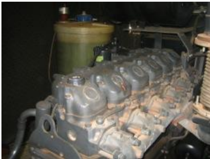
Foto 84: Detalhe do motor, mostrando os cabeçotes. Ao fundo, o tanque de combustível.
