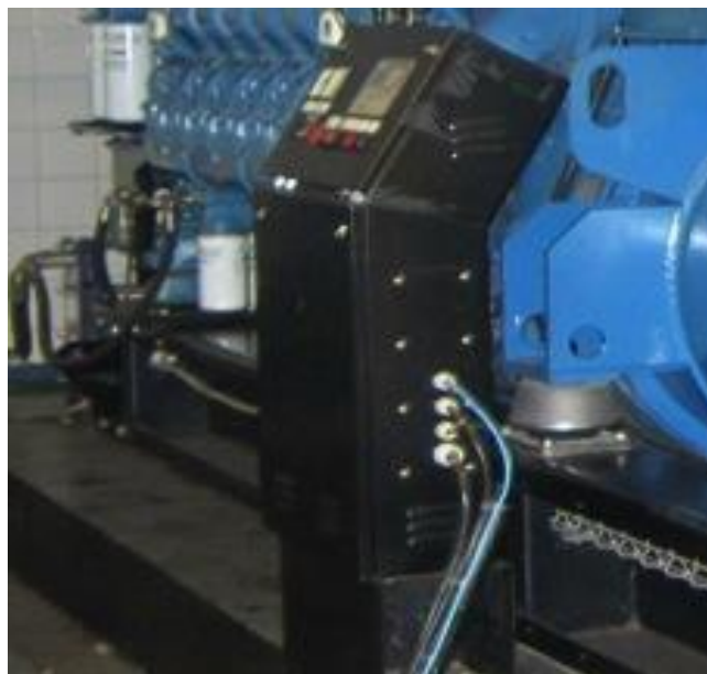
Foto 5: Perspectiva do totem de automação localizado ao lado do grupo gerador. O totem integra o objeto deste Anexo.
