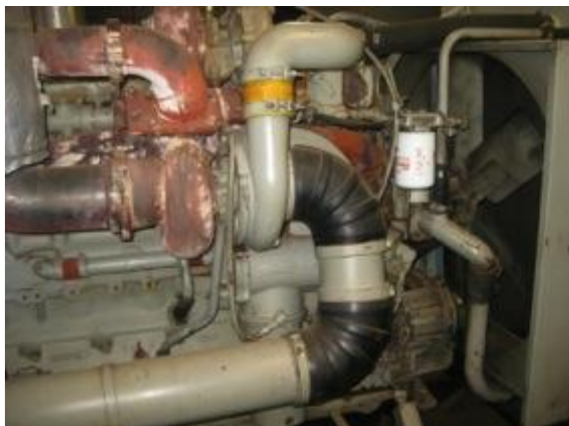
Foto 50: Detalhe do sistema de admissão e exaustão do motor. Nota-se o turbocompressor, e as juntas flexíveis do sistema de admissão. À direita, o filtro de água, o alternador, e o radiador.
