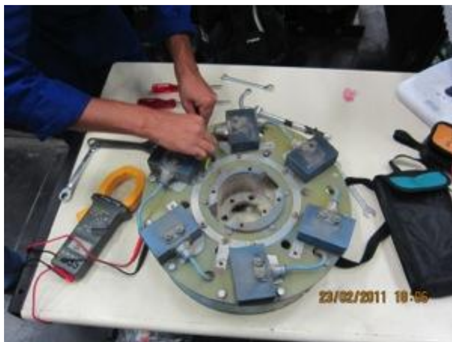
Foto 22: Detalhe de verificação realizada nos diodos da ponte retificadora girante.
