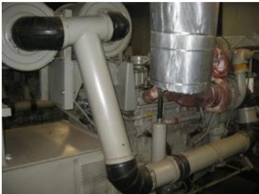
Foto 49: Detalhe do sistema de admissão de ar do motor. Em alumínio, parte do sistema de exaustão.
