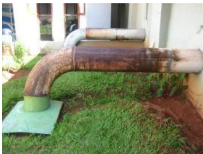
Foto 38: Saída dos escapamentos dos dois grupos geradores do galpão do Sistema de Geração de Energia Elétrica de Emergência do Senado Federal e entrada na galeria subterrânea de fumaça que conduz os gases até a chaminé, distante cerca de 100 metros (conforme primeira figura deste Apêndice Técnico).
