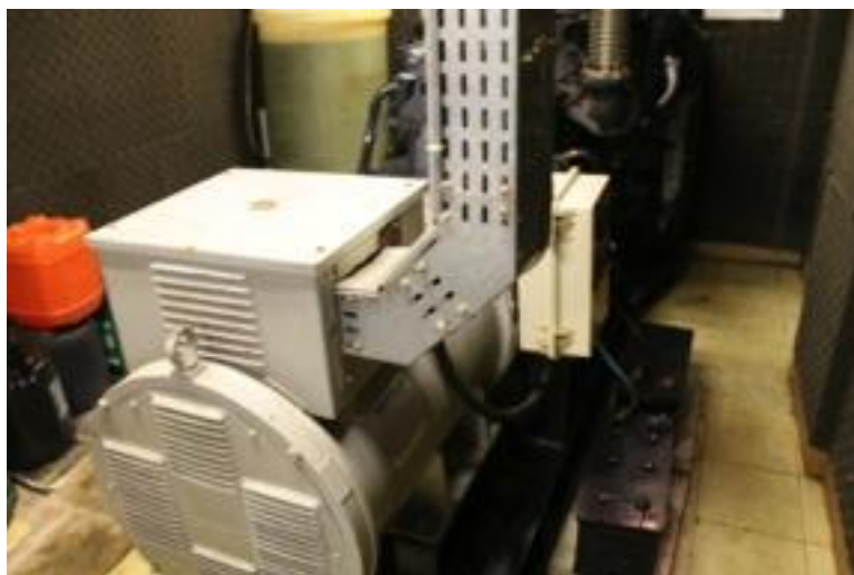
Foto 73: Vista lateral do grupo motor-gerador. Notam-se a calha dos condutores de potência e comando, o painel de instrumentos e as baterias do sistema de partida e automação.
