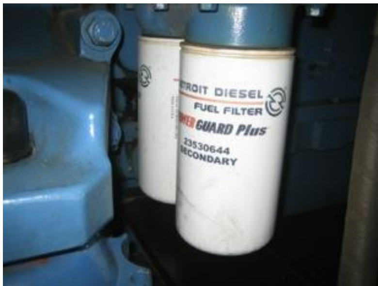
Foto 9: Detalhe dos filtros de combustível de um motor (2 filtros por motor).
