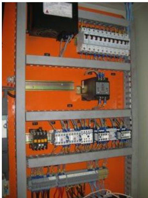
Foto 90: Detalhe da parte interna do painel de controle e potência do grupo motor-gerador. Nota-se a fonte, os disjuntores, o relé de falta de fase, as contadoras e as borneiras de automação.
