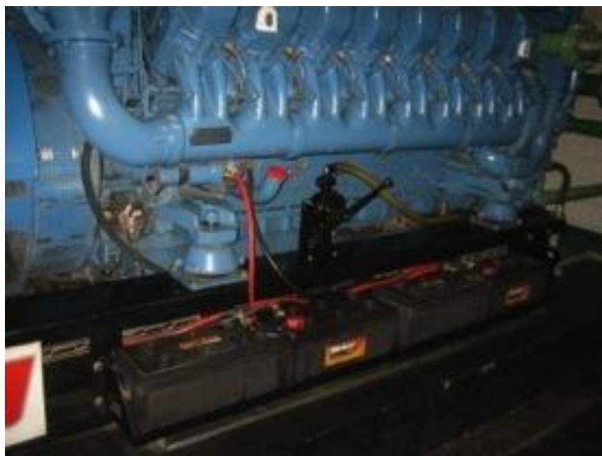
Foto 12: Conjunto de baterias de partida de um motor diesel (quatro baterias de 12 V). Na execução dos serviços especificados neste Anexo, estão previstas a manutenção e a substituição (em caso de necessidade) dos conjuntos de baterias de partida dos dois grupos geradores.
