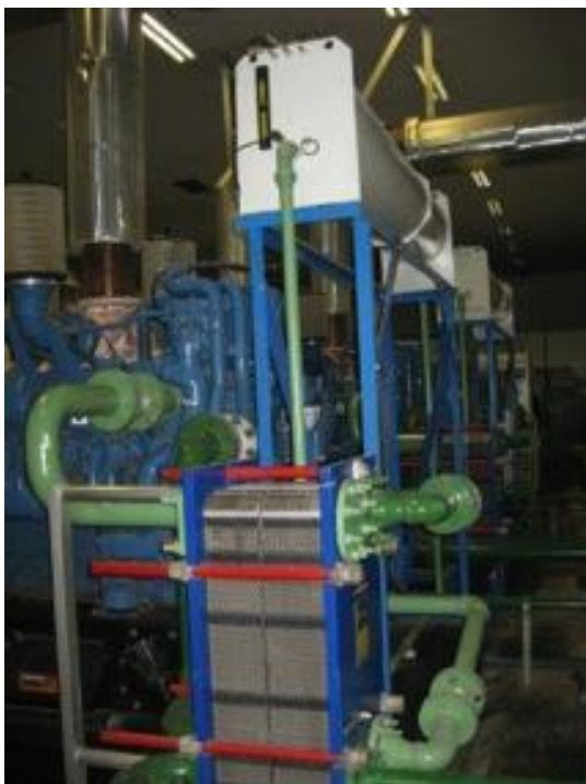
Foto 15: Detalhe do trocador de calor entre o circuito fechado de fluido de refrigeração de um motor e o circuito de água das torres de resfriamento externas. Trata-se de trocador de calor de placas Alfa Laval M10-MFM, com 74 placas e volume de 72 litros. Os serviços especificados neste Anexo preveem a manutenção regular desses trocadores de calor.
