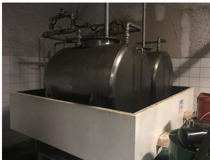
Foto 28: Detalhe dos dois tanques secundários de combustível localizados ao lado dos grupos geradores.
