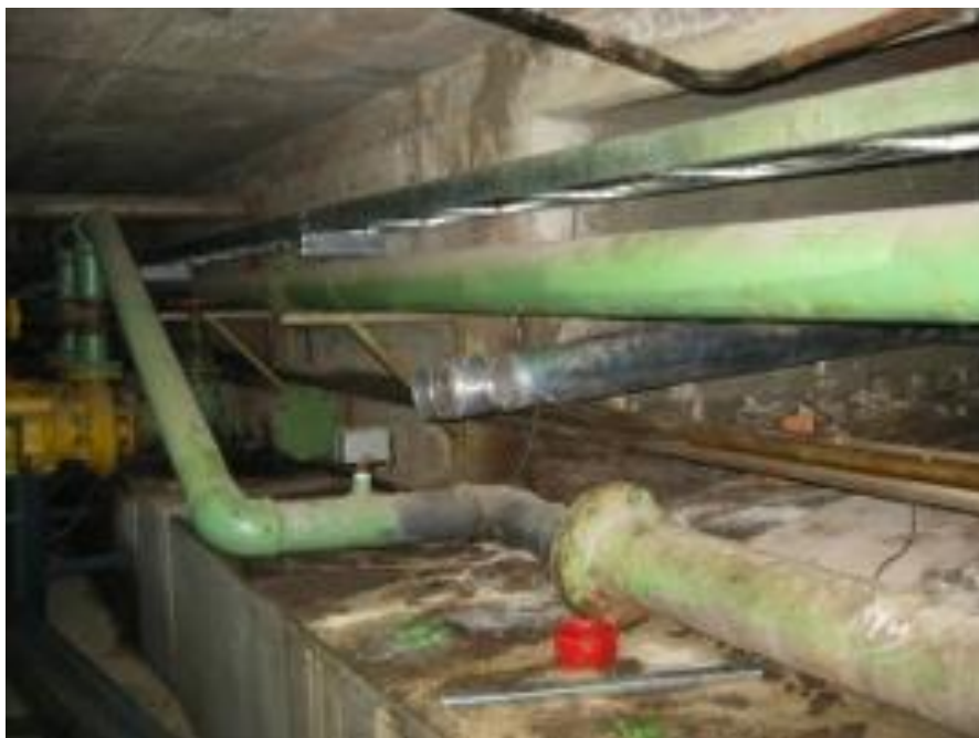
Foto 33: Detalhe da tubulação de água de refrigeração que conecta as torres de resfriamento aos grupos geradores.
