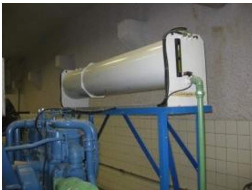
Foto 14: Detalhe de tanque de fluido de refrigeração do circuito fechado junto a um motor. Os serviços deste Anexo preveem a substituição do fluido de refrigeração e a limpeza dos respectivos tanques e tubulações.
