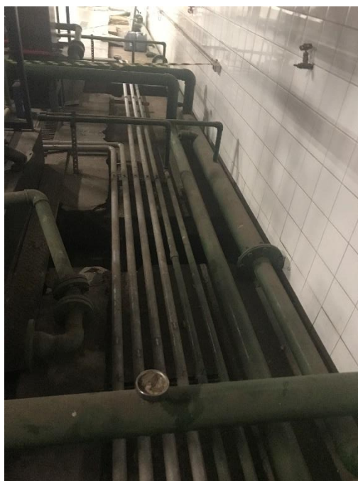
Foto 32: Detalhe das linhas de água de refrigeração que conectam os trocadores de calor de cada um dos motores às torres de resfriamento externas.
