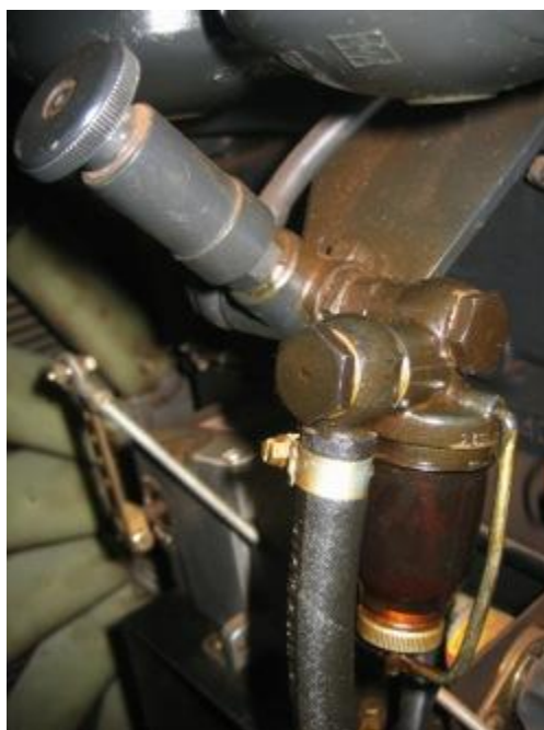
Foto 81: Detalhe do sistema de alimentação do motor, mostrando o separador de água e as mangueiras.
