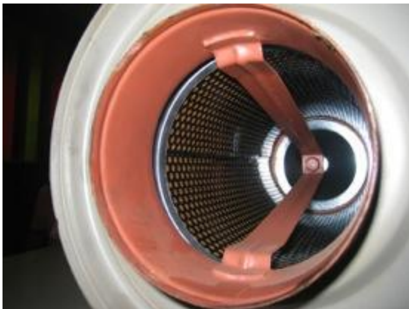
Foto 63: Detalhe da parte interna do filtro de ar utilizado nos grupos motores-geradores.
