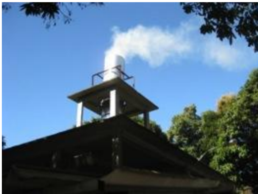
Foto 39: Chaminé única (distante cerca de 100 metros do local de instalação dos grupos geradores). Os serviços previstos e especificados neste Anexo preveem a manutenção mecânica e civil dessa chaminé, de seu motor elétrico, hélice de exaustão, painel de comando e demais componentes.
