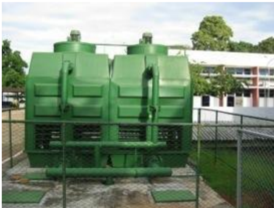
Foto 35: Torres de resfriamento de água.
