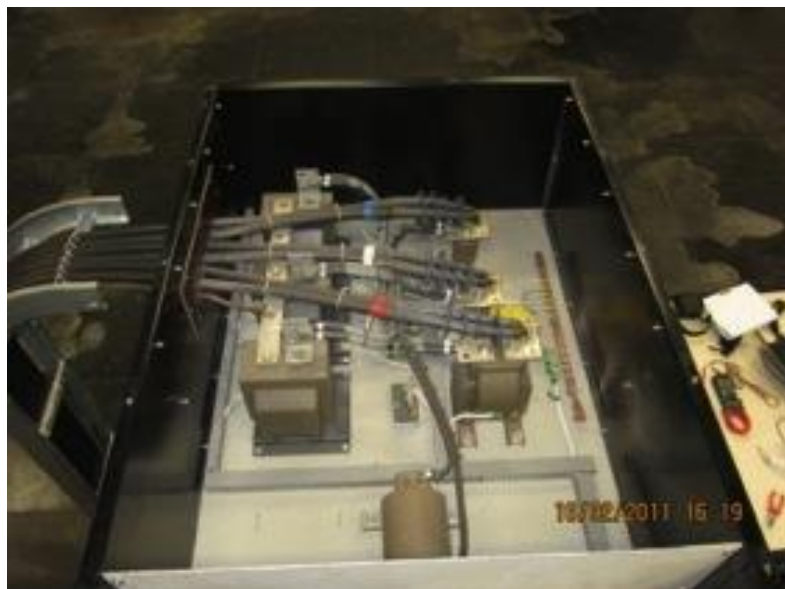
Foto 23: Detalhe dos TP's e TC's na caixa terminal no topo de um gerador.
