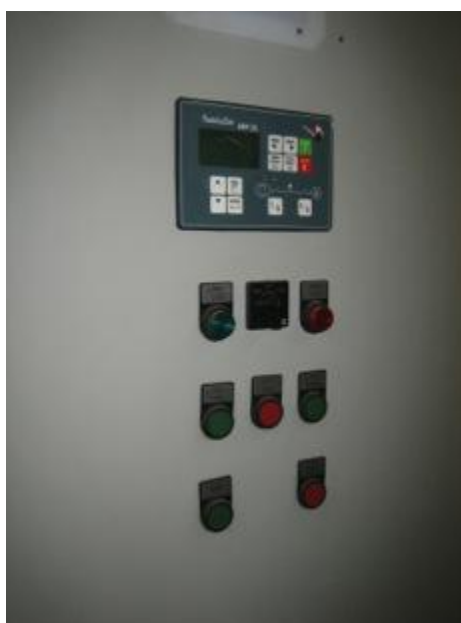
Foto 89: Parte externa do painel de controle e potência do grupo moto-gerador. Na parte superior, está instalado o controlador Comap InteliLite AMF 20.
