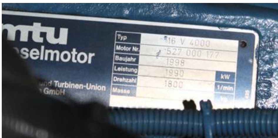
Foto 3: Placa do Grupo Motor-Gerador 2, com as seguintes informações: MTU Dieselmotor, MTU Motoren- und Turbinen-Union Friedrichshafen GmbH, Made in Germany, Typ: 16 V 4000, Motor Nr. 527 000 177, Baujahr 1998, Leistung 1990 kW, Drehzahl 1800 1/min, Masse (em branco) kg.
