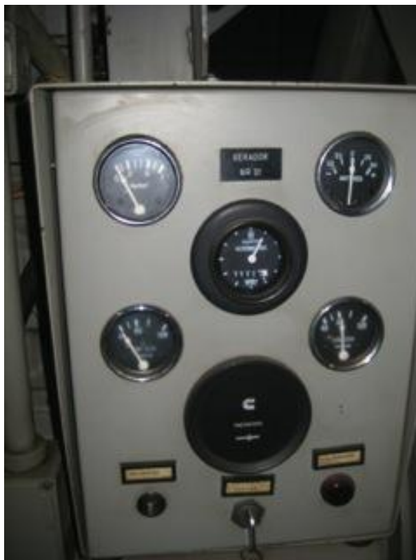
Foto 61: Detalhe do conjunto de instrumentos. Entre eles, estão o medidor de pressão, o amperímetro, o horímetro, e temperatura da água e do óleo.
