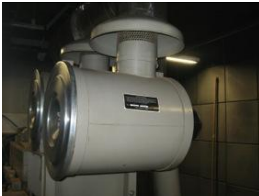
Foto 51: Detalhe do sistema de admissão de ar motor. Na placa estão algumas instruções de manutenção. Em especial, “Filtro, Peça N°. Cummins 3351734” e “Elemento Primário, Peça N°. Cummins 3351735”.
