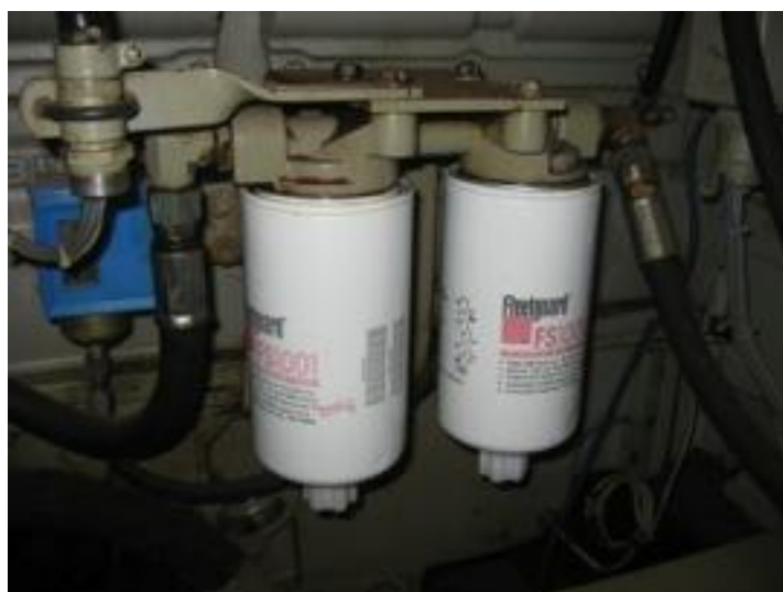
Foto 62: Detalhe do filtro combustível (atualmente, dois Fleetguard FS1001) utilizado nos grupos motores-geradores.
