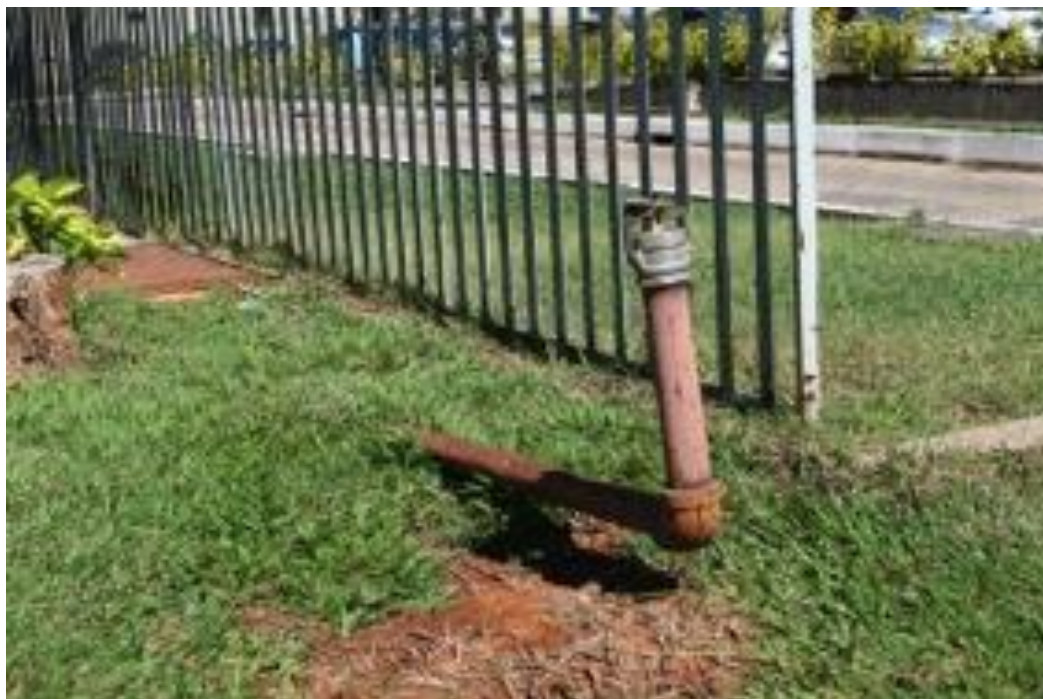
Foto 65: Detalhe da entrada de abastecimento de óleo diesel.
