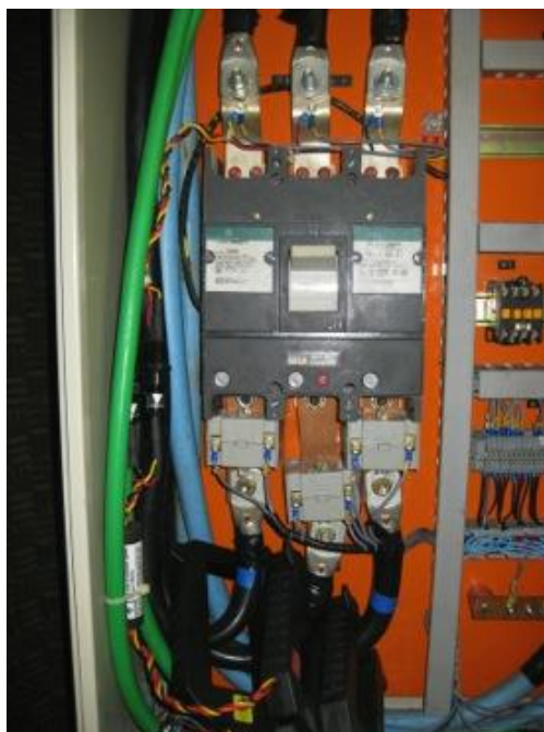
Foto 91: Detalhe do disjuntor principal do grupo motor-gerador.
