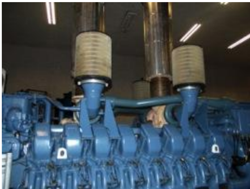
Foto 11: Em primeiro plano no alto da foto, pode-se ver os filtros de ar de um motor diesel (cada motor possui 4 filtros de ar).
