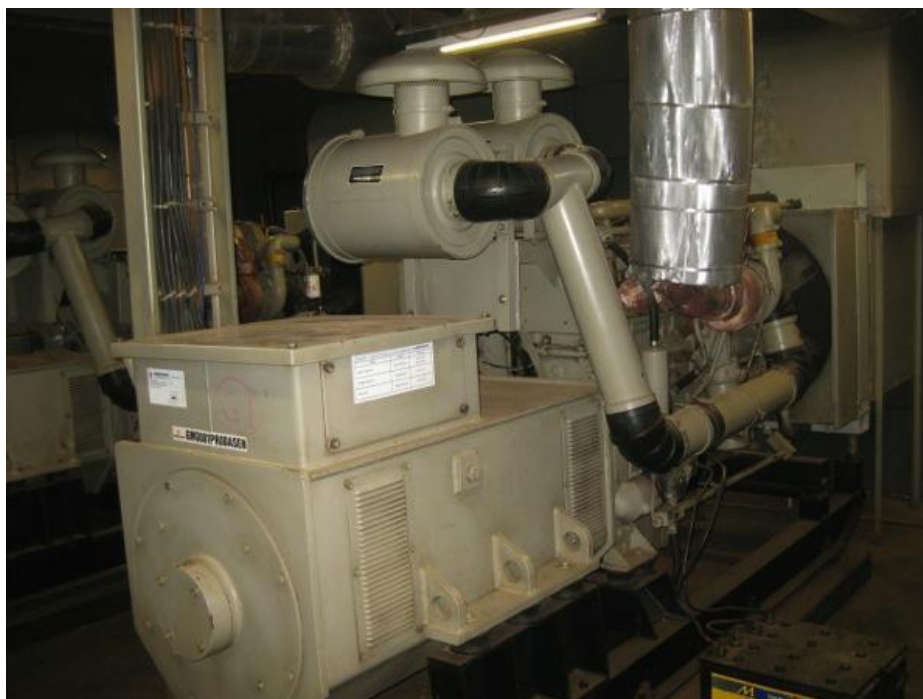
Foto 46: Visão geral do grupo motor-gerador 1, detalhando o sistema de admissão e escape de ar. Na parte inferior direita, as baterias de partida do grupo motor-gerador. Ao fundo, o grupo motor-gerador 2.
