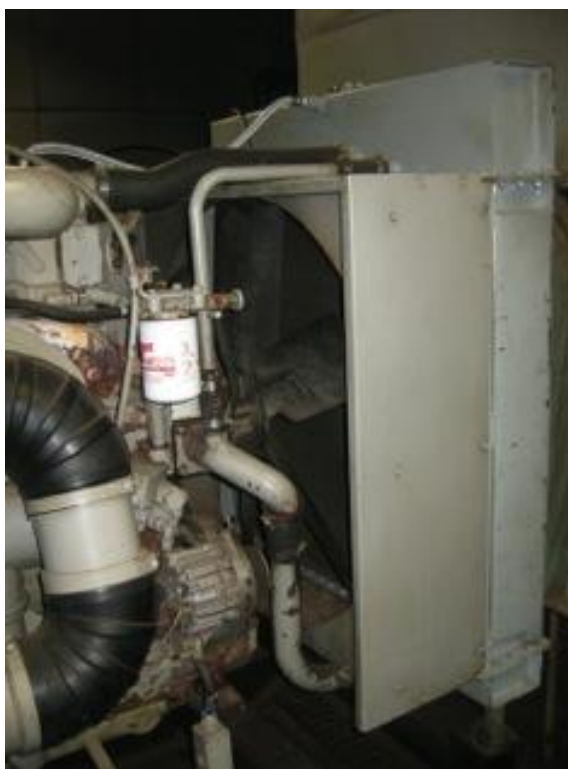
Foto 52: Detalhe do radiador e do sistema de exaustão do motor.
