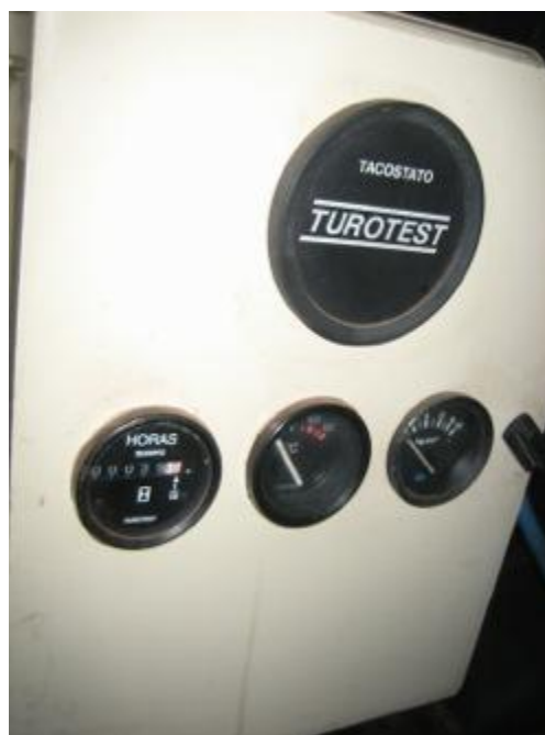
Foto 87: Detalhe dos instrumentos de supervisão do motor.
