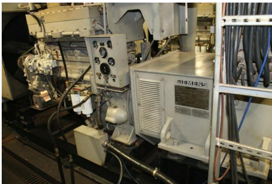
Foto 48: Visão geral do grupo motor-gerador, detalhando os instrumentos e o gerador. Nota-se que os condutores de comando dentro do motor foram passados utilizando eletrodutos rígidos e flexíveis.
