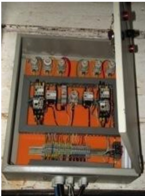
Foto 37: Quadro de comando do sistema de água de refrigeração do Sistema de Geração de Energia Elétrica de Emergência do Senado Federal.
