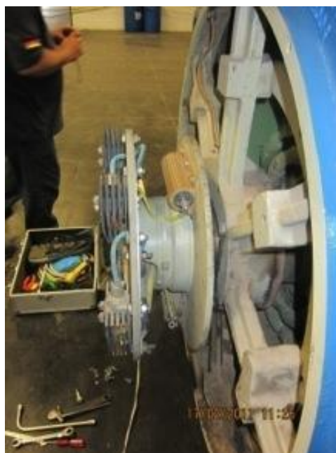
Foto 20: Detalhe da ponte retificadora do rotor. Observe-se que o conjunto de diodos e as resistências encontram-se afixados na parte girante do rotor.
