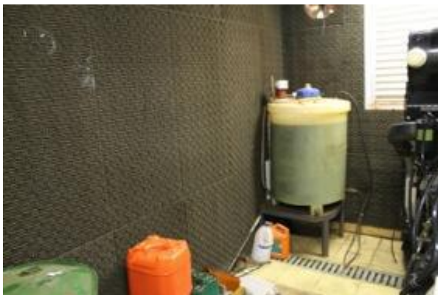
Foto 85: Detalhe do tanque, e do isolamento acústico da sala do grupo motor-gerador.
