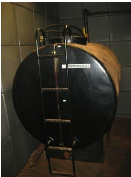
Foto 64: Tanque de óleo diesel, com capacidade aproximada de 1.600 litros.
