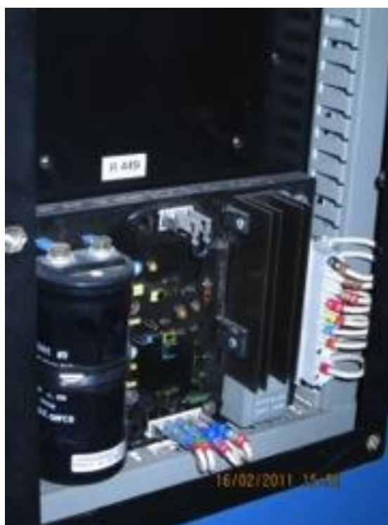
Foto 24: Regulador automático de tensão R449 embutido na caixa superior do gerador Leroy-Somer. Os serviços deste Anexo preveem a manutenção desse regulador, inclusive com substituição e reparo de materiais e reajuste de seus trimpots e jumpers , se necessário.
