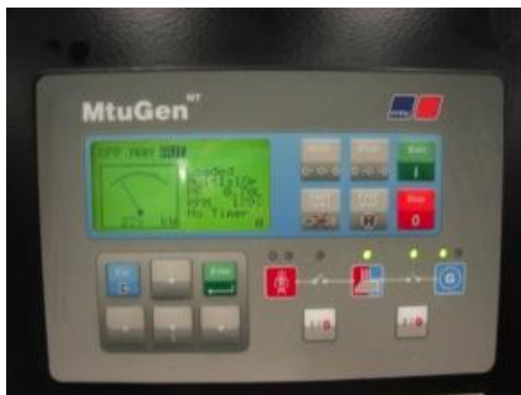
Foto 6: Vista frontal da IHM (Interface Homem-Máquina) do controlador modular para grupos geradores InteliGen-NT (código IG-NT GC) presente em cada um dos dois totens de automação.
