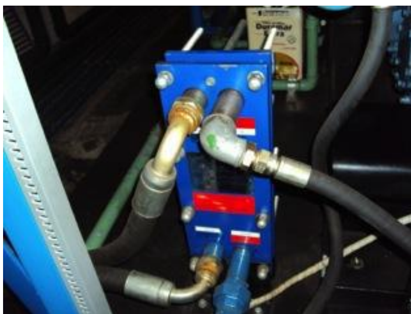
Foto 10: Trocador de calor da linha de combustível. Trata-se de trocador de calor de placas Alfa Laval M3-FG, com 11 placas e volume de 1 litro, que também tem manutenção prevista nos serviços especificados neste Anexo.
