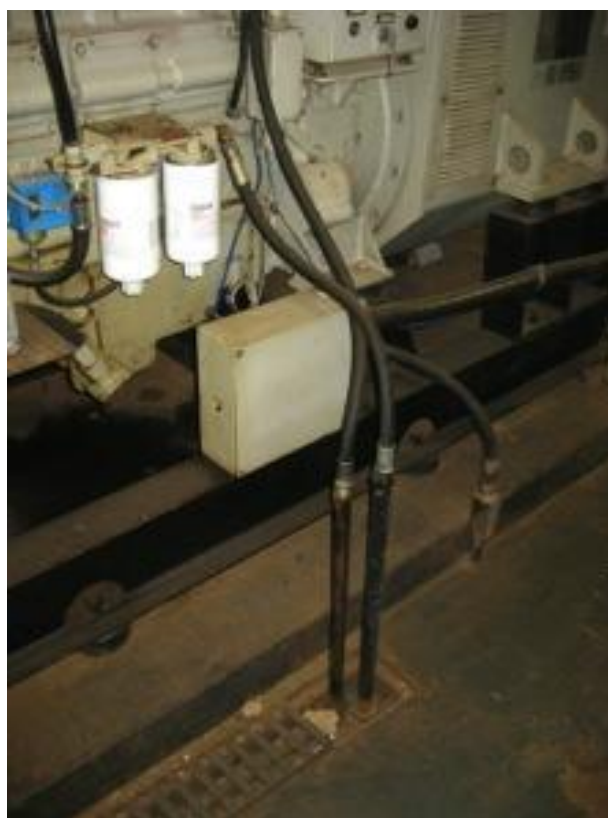
Foto 56: Detalhe dos dutos de alimentação de combustível. Ao fundo, no motor, os dois filtros de combustível.
