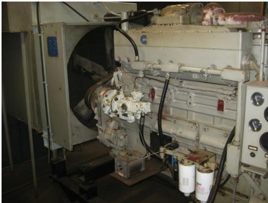
Foto 47: Visão geral do grupo motor-gerador, detalhando a bomba injetora, o acelerador, o atuador e os filtros de combustível. Ao fundo, a ventoinha e o radiador.
