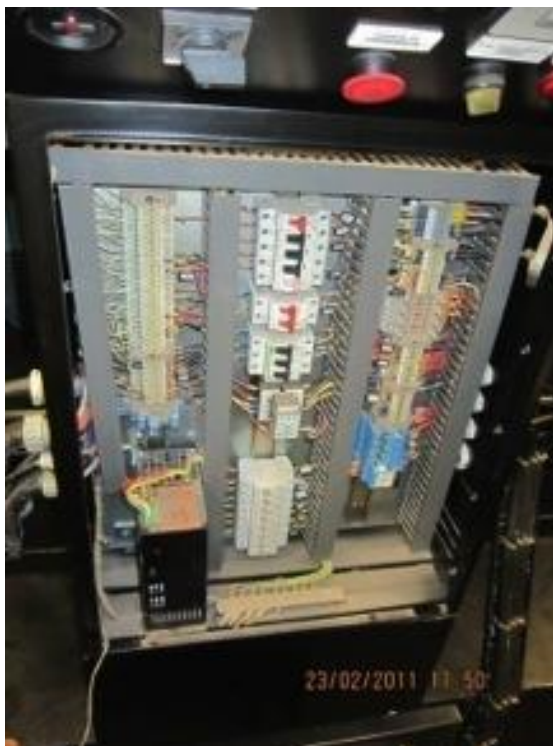
Foto 7: Totem de comando junto a um dos grupos geradores (parte inferior). Note-se carregador de baterias, DPSs e disjuntores dos sistemas auxiliares de partida e controle (todos inclusos no objeto da manutenção a ser contratada).
