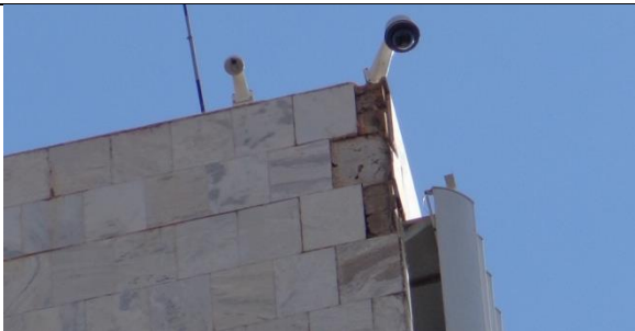
Figura 5 - Anexo 01 - Exemplo de dano: placas faltantes
