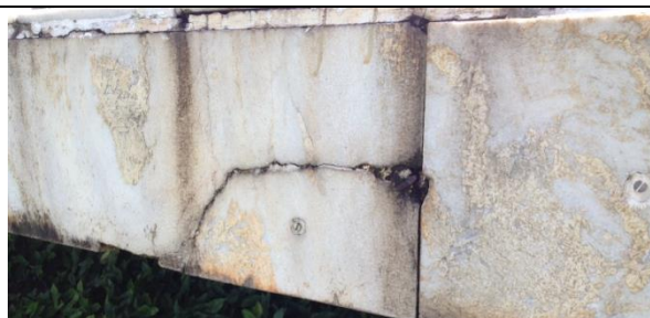
Figura 24 - Rampa do Edifício Principal - Exemplo de danos
