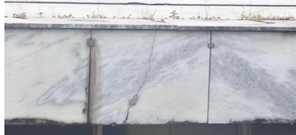
Figura 14 - Edifício Principal – Exemplo de placas partidas em outros pontos
