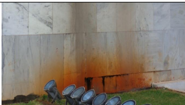
Figura 9 - Túnel do Edifício Principal - Peças manchadas
