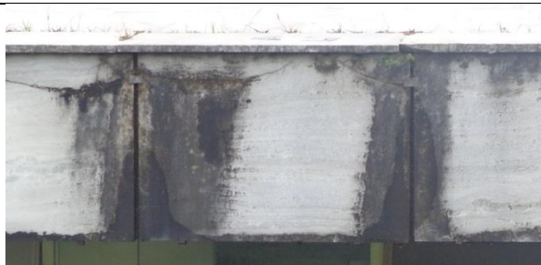
Figura 15 - Edifício Principal - Exemplo de peças manchadas
