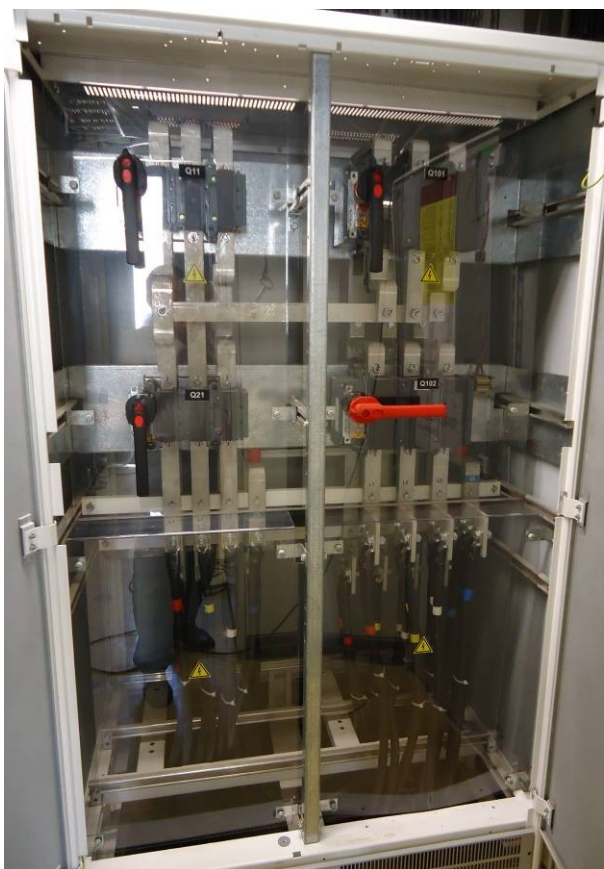
Foto 2 – Quadro de bypass dos nobreaks
