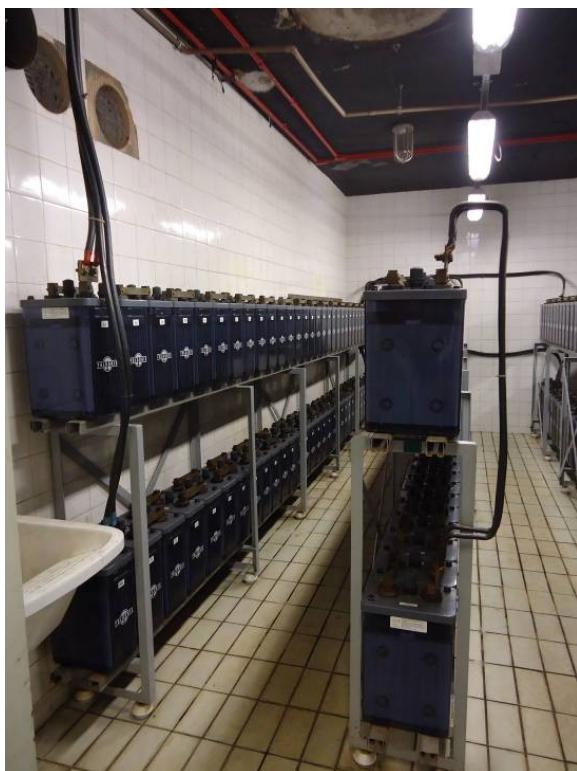
Foto 7 - Bancos de baterias
