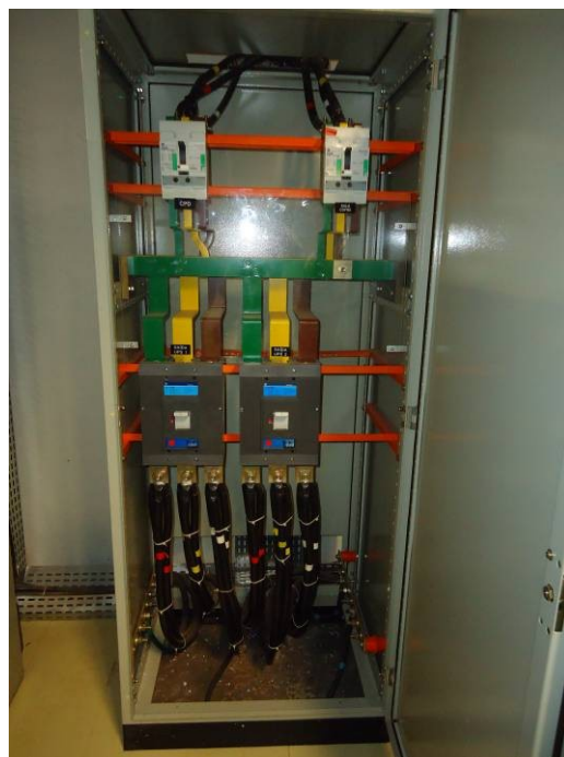
Foto 5 – Quadro de energia p/ o data center
