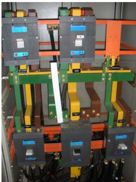
Foto 6 – Quadro Geral de Energia - QGE
