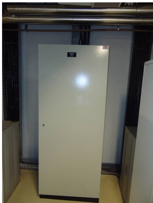
Foto 4 – Quadro de energia p/ o data center
