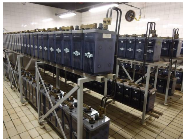
Foto 8 - Bancos de baterias
