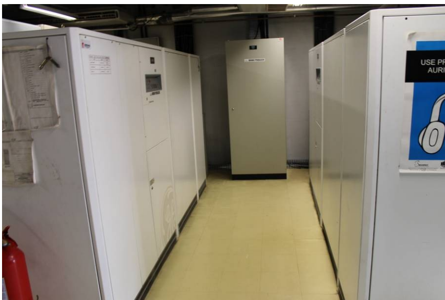
Foto 1 – Dois nobreaks GE SitePro Series 6 de 300 kVA
