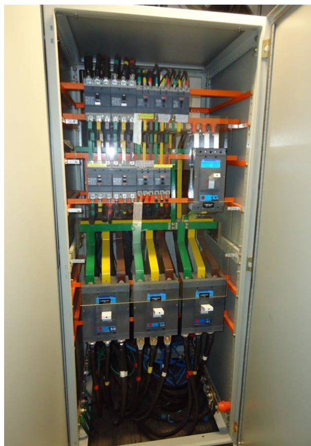
Foto 3 – Quadro de saída dos nobreaks
