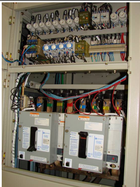
Chave de transferência automática e temporizadores relacionados
