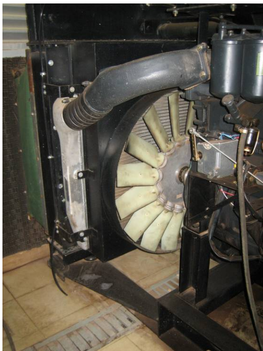
Detalhe da refrigeração e controle automático da aceleração mecânica.
