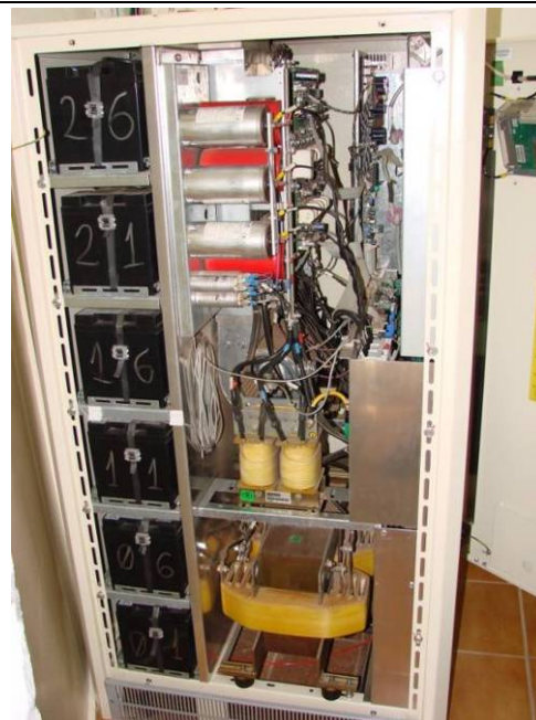
No-break 15kVA. Observe o transformador, capacitores, banco de baterias e ventilador centrífugo conectado ao dissipador de calor.
