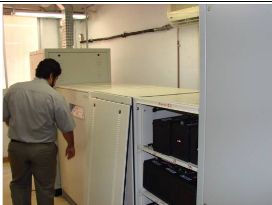
GE SitePro 135kVA e respectivo banco de baterias.
