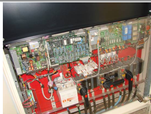
Placas de controle e driver do no-break de 135kVA.
