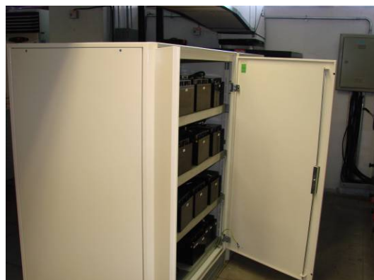
Banco de baterias integrante do no-break de 60kVA.
