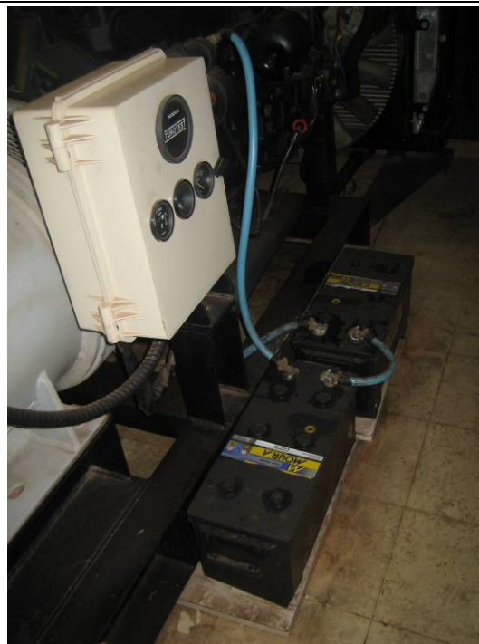
Baterias para partida do grupo gerador
