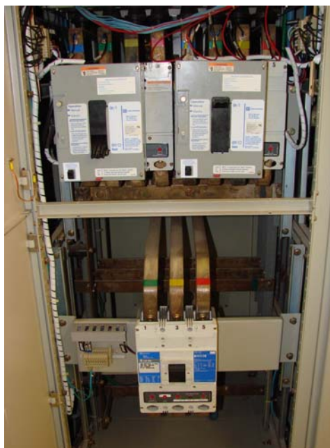
Detalhe da chave de transferência automática e disjuntor de saída (ou seja: que alimenta a carga)
