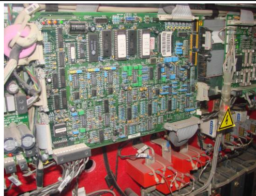
GE SitePro 80kVA Placa de controle e TCS.
