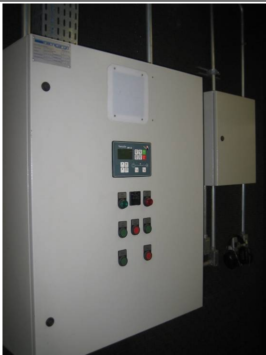
Quadro de comando do grupo gerador. Todo esse equipamento está incluso no contrato.
