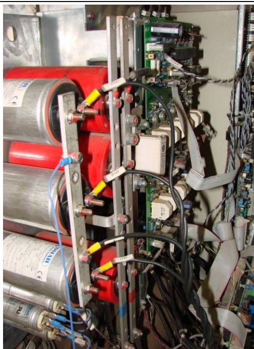
GE SitePro 15kVA (capacitores e placa de driver internos ao gabinete).
