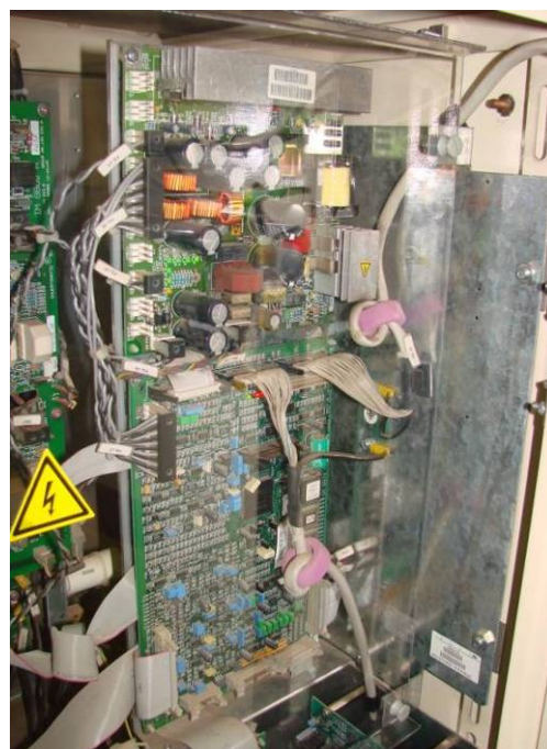
GE SitePro 15kVA (placa de controle interno ao gabinete).
