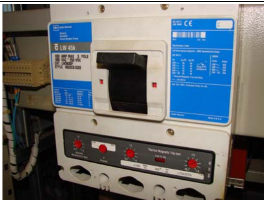
Disjuntor de entrada da CEB (provê a energia normal para a chave de transferência ao lado). Marca: Cutler-Hammer. cat. LW3630F / STYLE 6633C84G03
