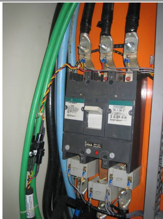
Disjuntor de proteção do grupo gerador com sensores de corrente (TCs) e tensão que provêm informações para o quadro de comando do grupo gerador e USCA.
