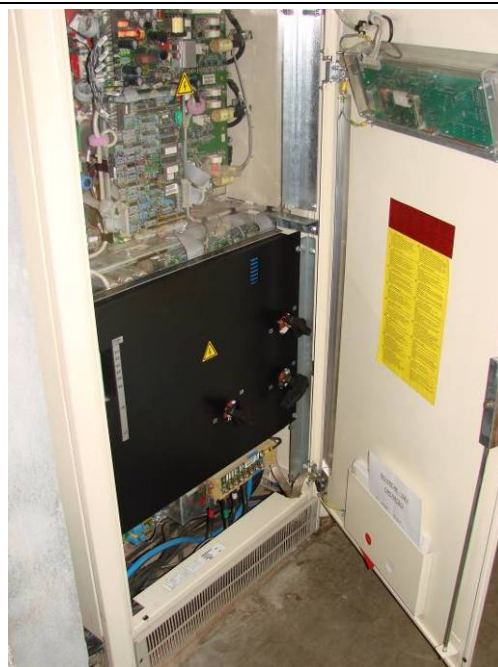
GE SitePro 60kVA (placa de controle e placa de driver internas ao gabinete).
