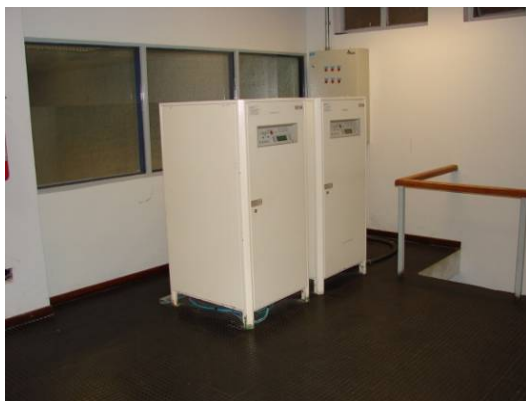
02 (duas) unidades do no-break GE SitePro 15kVA (banco de baterias interno).
