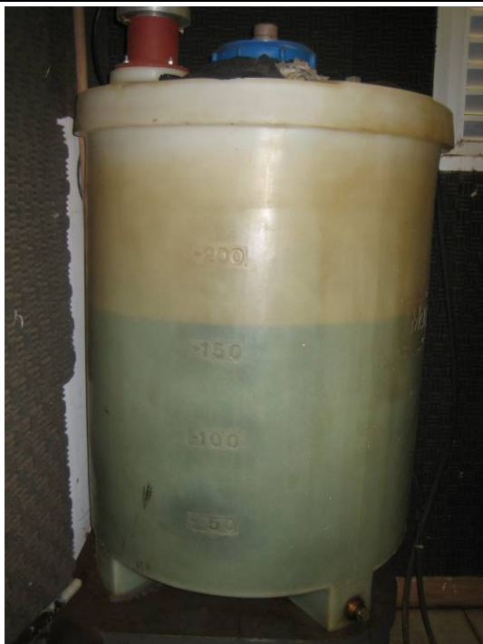
Reservatório de óleo diesel.
