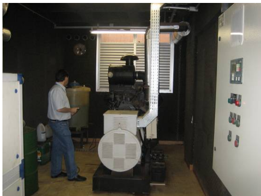
Grupo gerador a diesel do edifício Interlegis. Potência 275kVA. Motor Mercedes-Benz. Gerador Weg. Quadro de comando com unidade de supervisão e controle (USCA).
