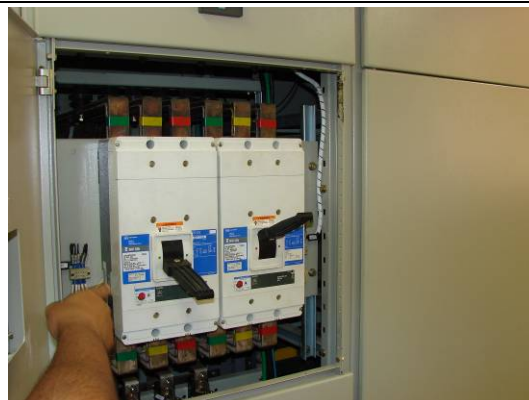
Chave de manobra manual normal/emergência. Marca: Cutler-Hammer NE 50k, 1250amps, 690Vac, cat. NW3126T33W STYLE 1488D10G09
