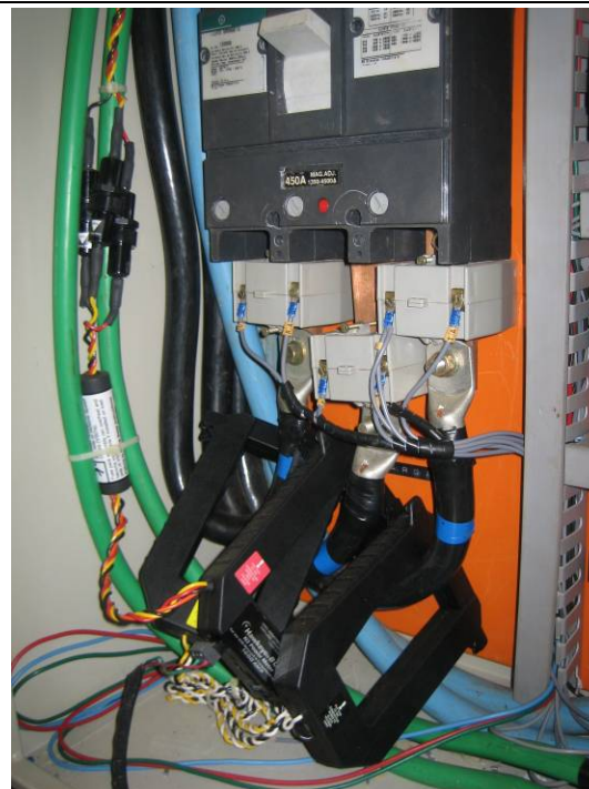
Detalhe dos sensores de corrente (TCs) do disjuntor de proteção do grupo gerador.
