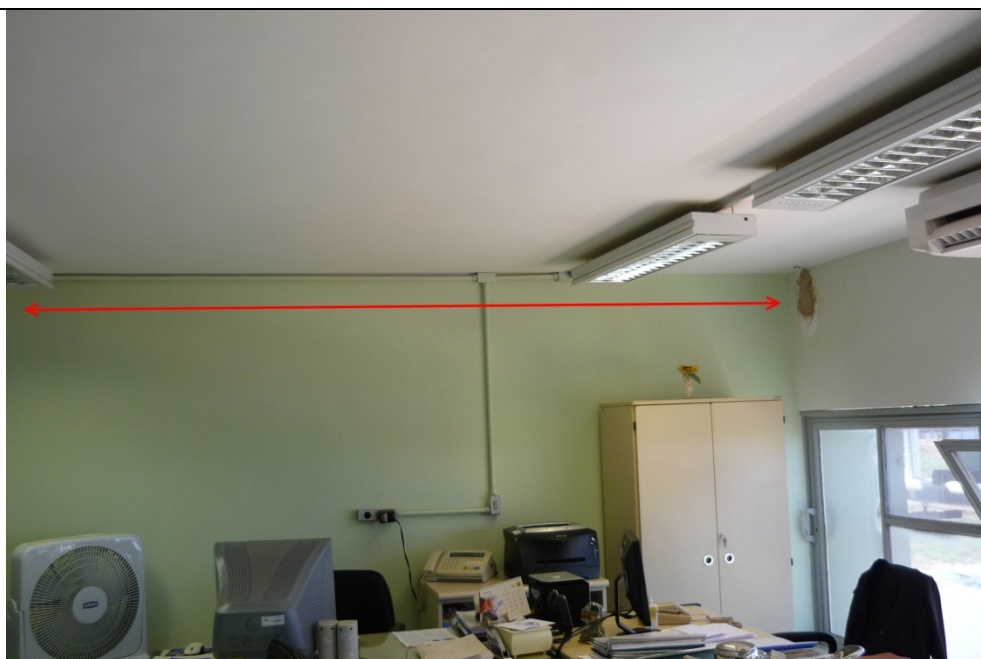
Figura 4. Passagem da rede de água gelada (um andar acima do local de instalação).
