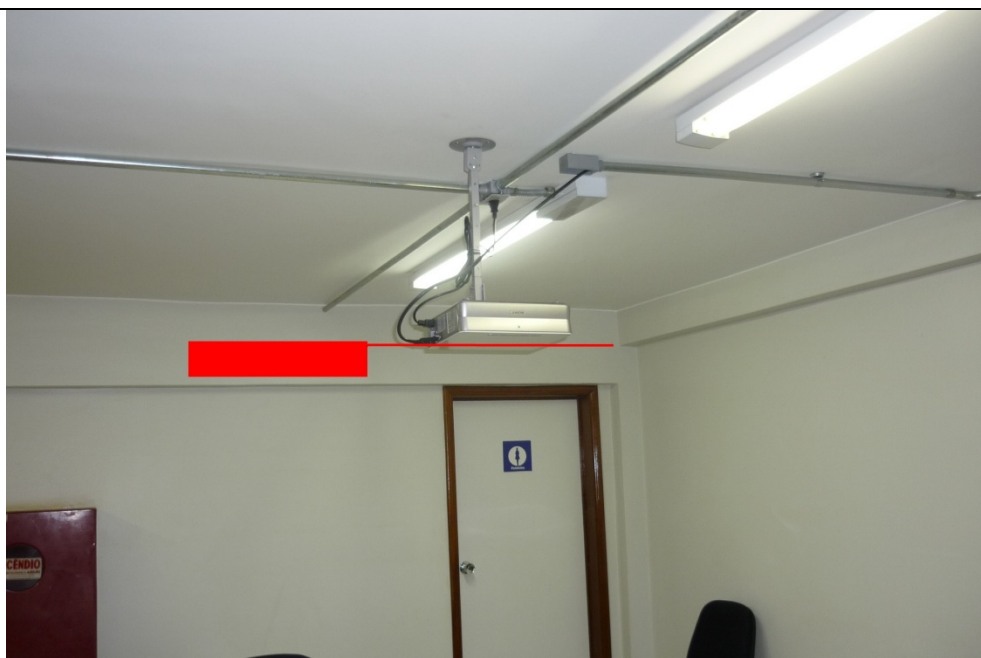
Figura 5. Posição de instalação do fancolete e tubulação de água gelada na Secretaria de Arquivo.
