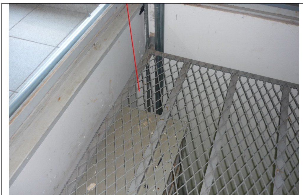
Figura 9. Posição da tubulação de água gelada na Secretaria de Arquivo (com indicação do local para furo da tela metálica, um andar acima do local de instalação).
