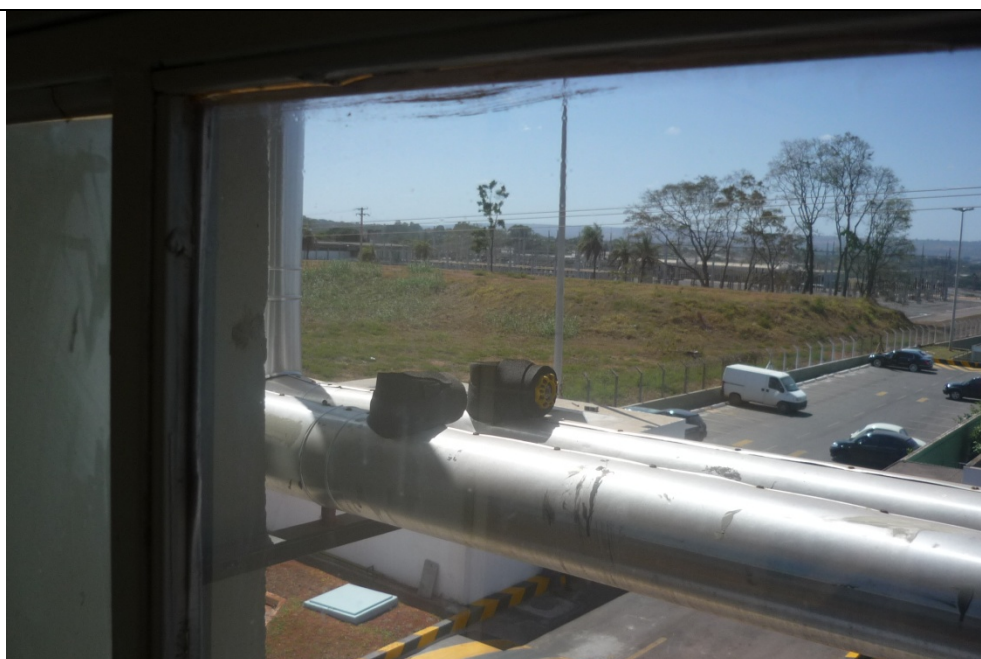
Figura 3. Ponto de interconexão na rede principal (um andar acima do local de instalação).
