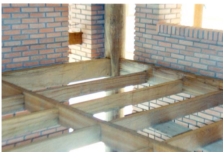
1) Estrutura de madeira
