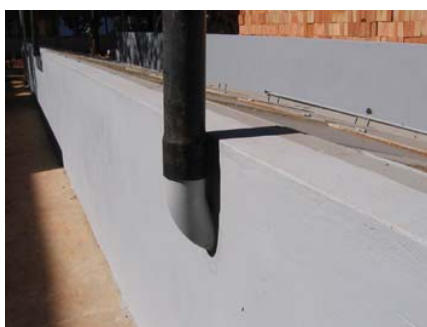
4) Detalhe da ventilação
