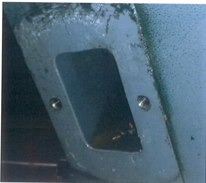
Foto 5: Correção do vazamentos de óleo das unidades 1,2,3,4
